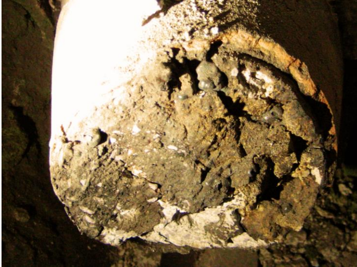
Oberfläche eines Schlitzspülers nach Ausbau
